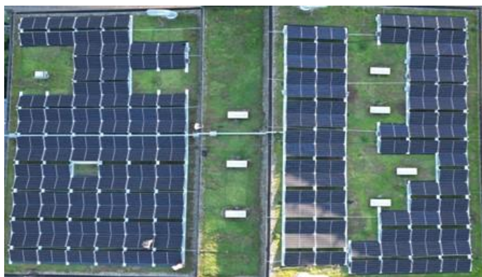
Abbildung 1: Neue PV-Anlage „EB05“
